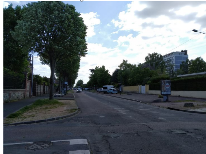
Surface de la voirie dégradée
