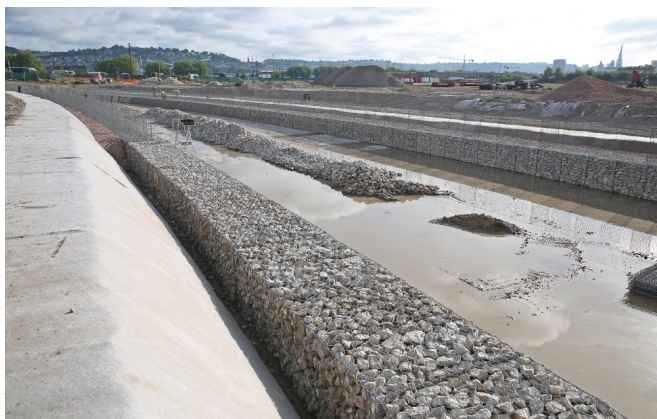
Bassin assainissement du projet « bassin Madagascar »
