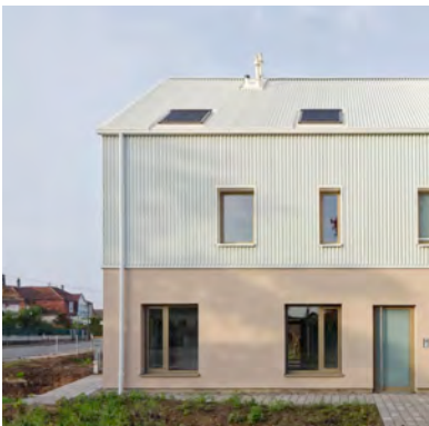
Absence de boîte à eau ballast, Rixheim
