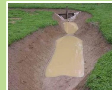
Fossé de collecte
