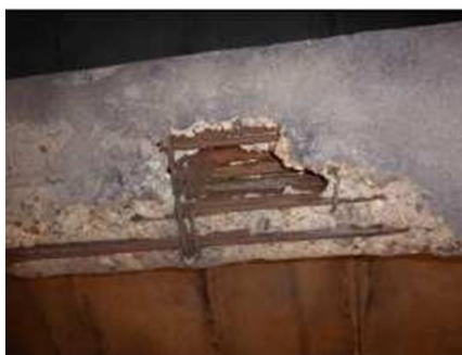
Éclats de béton et fers apparents sur la majorité des éléments de l'ouvrage
