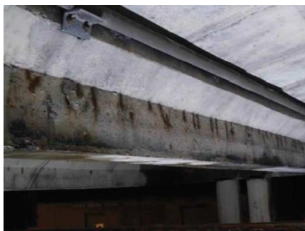
Zone de béton altérée
