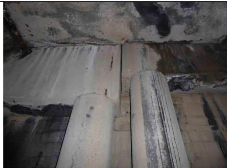
Décalage altimétrique au droit de la poutre de rive, travée M14-M16 (photographie avant nettoyage)
