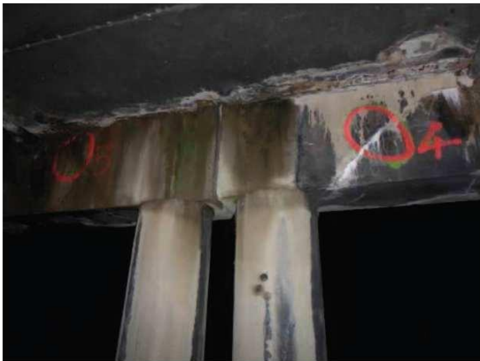
Fissures biaises instrumentées sur poutre de rive (photographie avant nettoyage)
