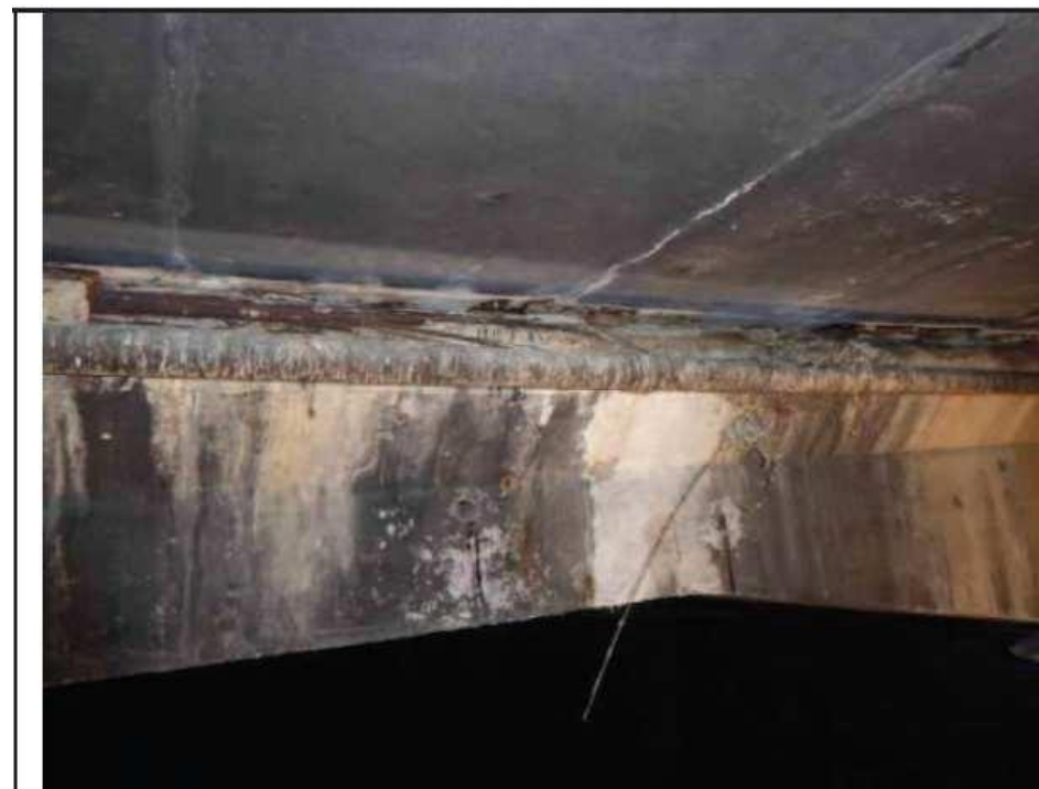
Câbles de précontrainte intérieure rompus dans la poutre transversale centrale M35-M36 (photographie avant nettoyage)
