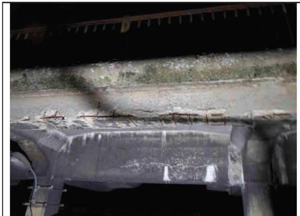
Eclats de béton et fers apparents sur la poutre de rive (photographie après nett.)
