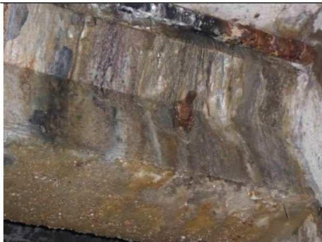
Gaine de précontrainte supplémentaire dégradée (photographie avant nettoyage)
